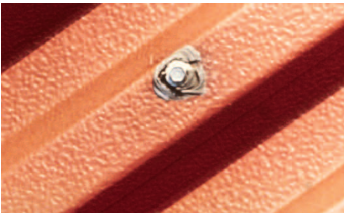
Beschädigte Halterung auf einer Dachbekleidung
